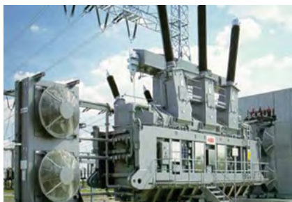
图 1 高压输电中使用的变压器。
