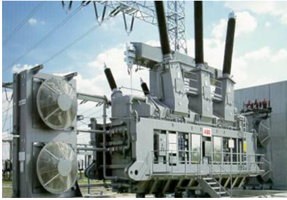
图 1. 高压输电中使用的变压器。
