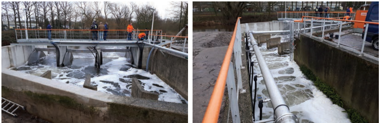
图 7. 工作状态下的埃因霍温污水处理厂的曝气通道, 它有效增加了注入多梅尔河水中的含氧量。左: 曝气通道出口处的可调出水堰。右: 从曝气通道的入口观察曝气通道。
